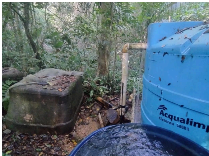
FIGURA 4: Antigas caixas de água utilizadas no sistema de abastecimento.
